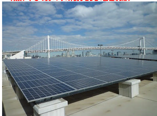
上屋の屋上に設置
