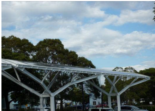
駐車場に設置
